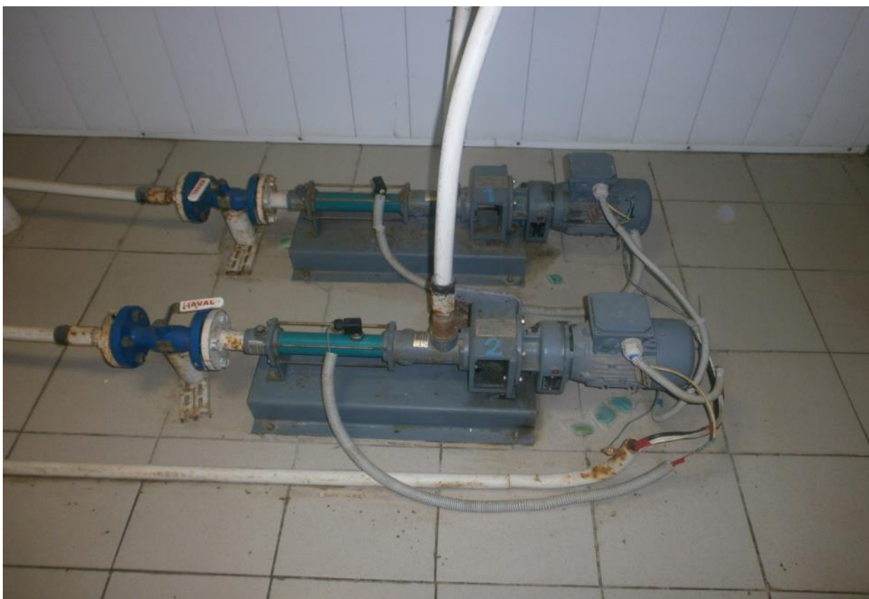
Рисунок 12-2. Станция приготовления раствора флокулянта на КОС 18 000 м 3 /сут.
