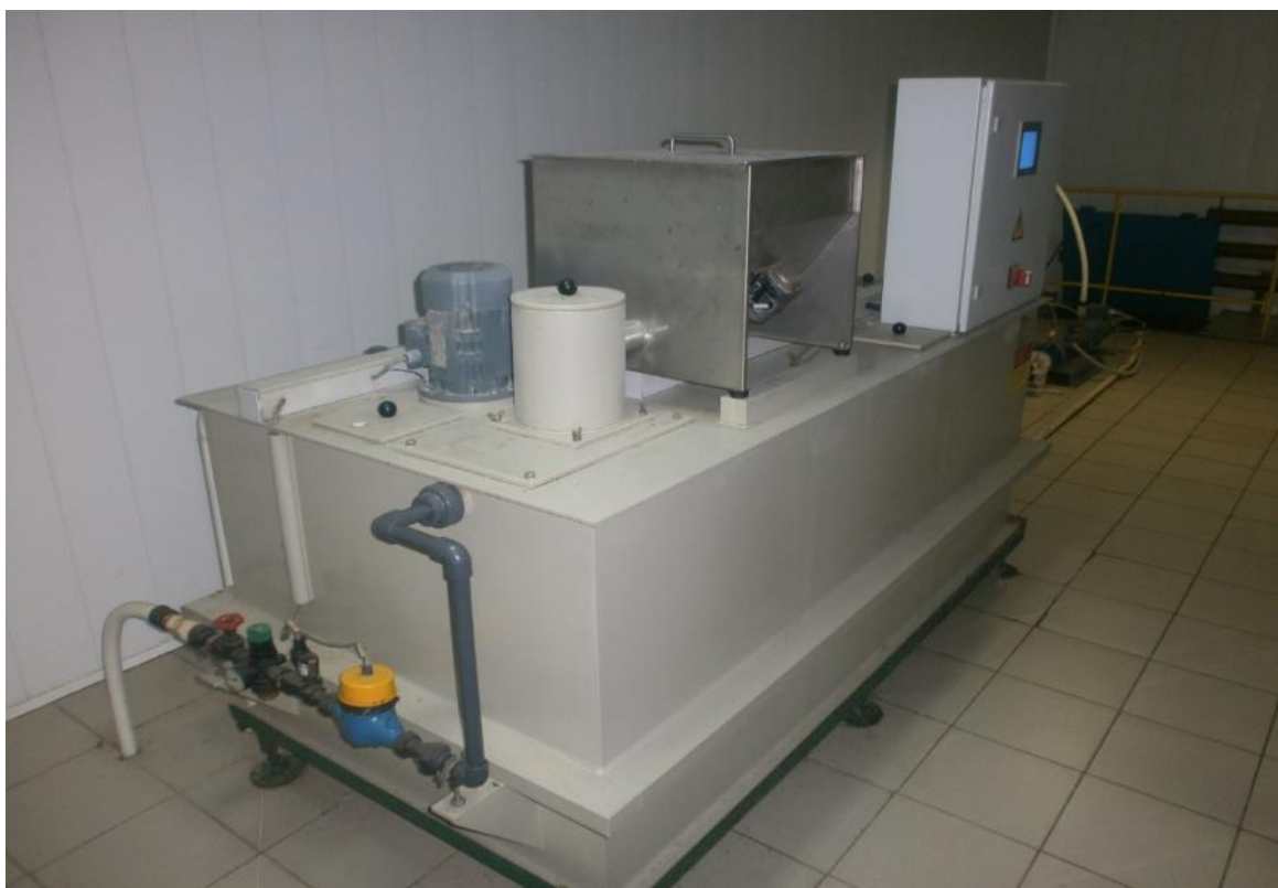
Рисунок 12-1. Станция приготовления раствора флокулянта на КОС 18 000 м 3 /сут.
